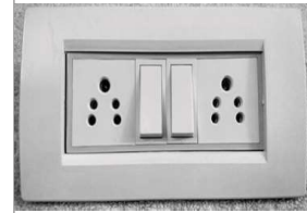
162. Switchboard സ്വിച്ച് ബോർഡ്
